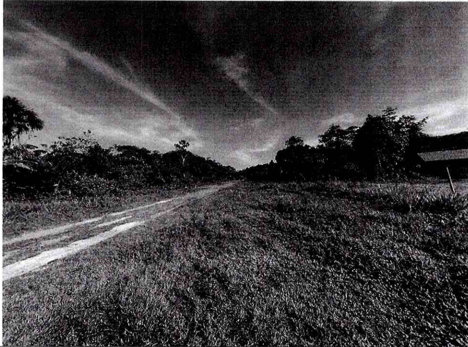
Foto 2: Pista Actual Longitud 400 metros con deterioro de la calzada.
