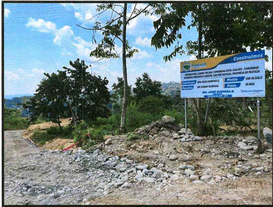
Anexo No. 1 Registro fotográfico de la colocación de pancarta informativa (letrero en la ejecución de la obra)
