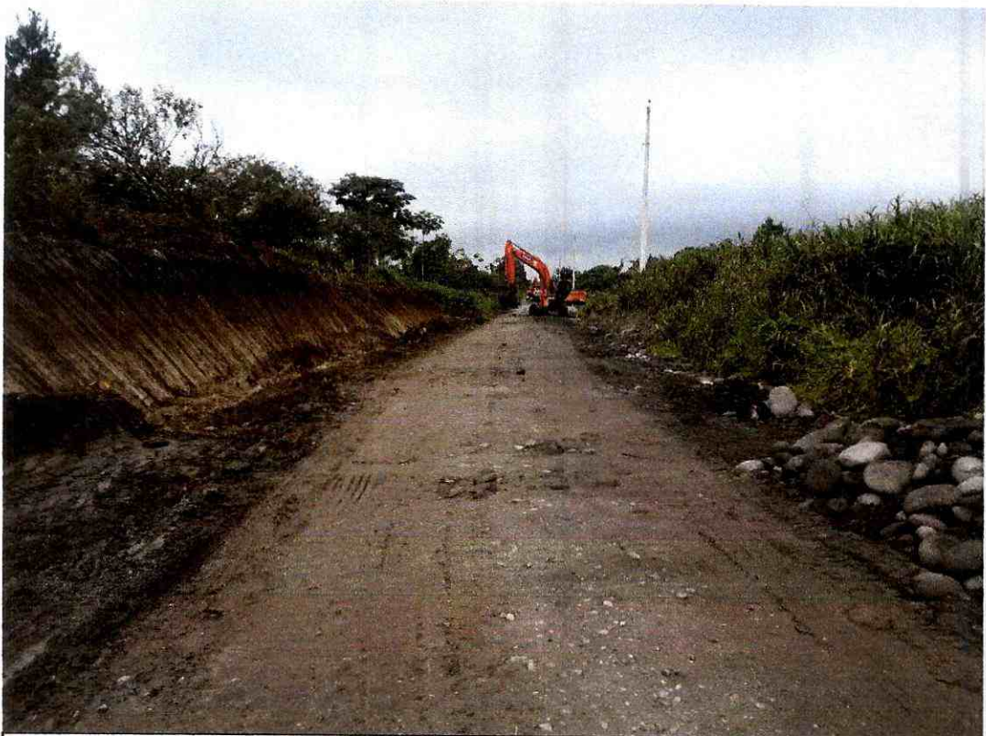
FOTO 9.- Excavación de cajas y taludes margen izquierdo. ABCISA: 3+600 a la 3+680 Fecha: 25 de junio del 2020
