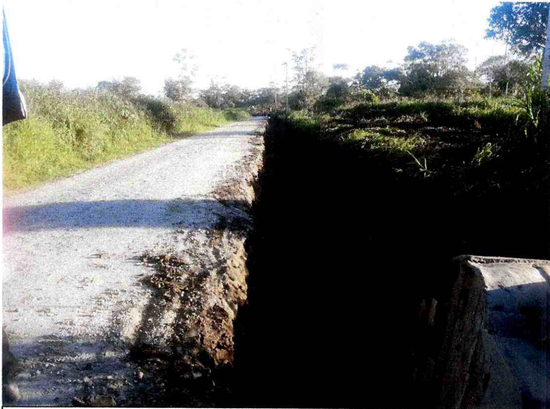
FOTO 4.- Excavación de cajeras al margen izquierdo de la vía ABCISA: 3+420 a la 3+520 Fecha: 17 de junio del 2020
