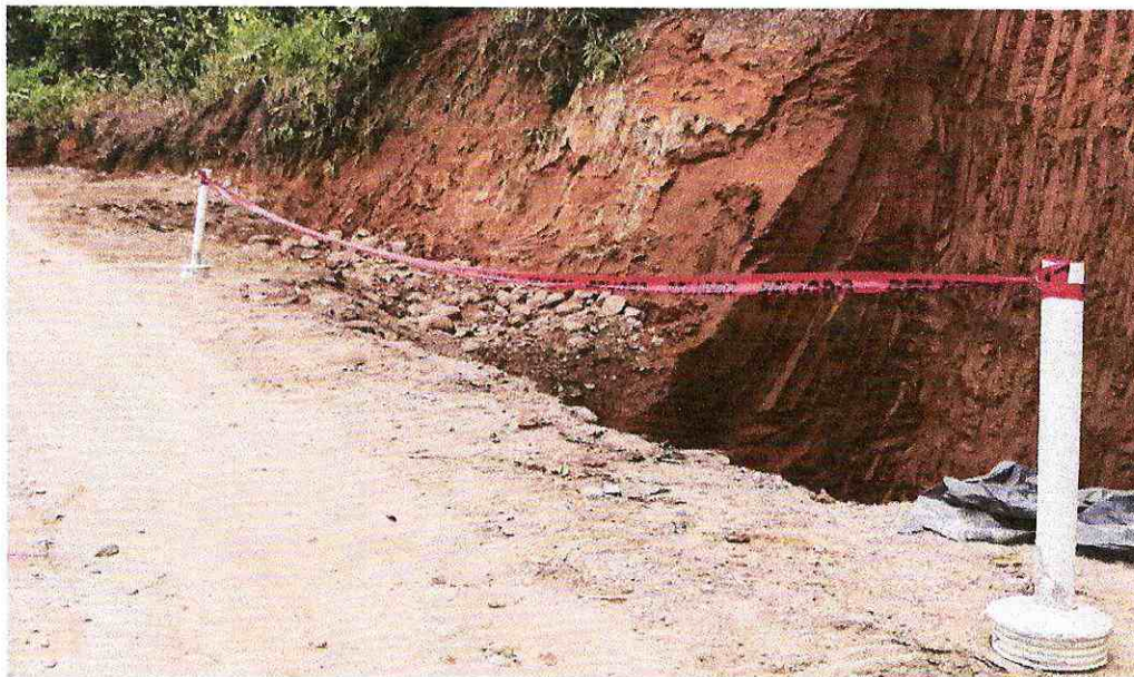
Fotografía 20 y 21. Delimitación de áreas intervenidas con cinta de peligro
