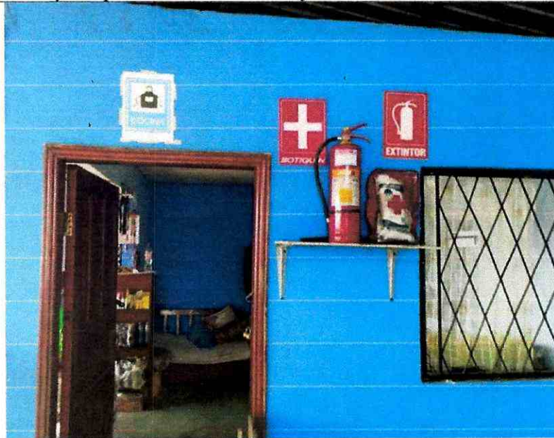
Anexo N°7. Extintor y botiquín al alcance de los trabajadores
