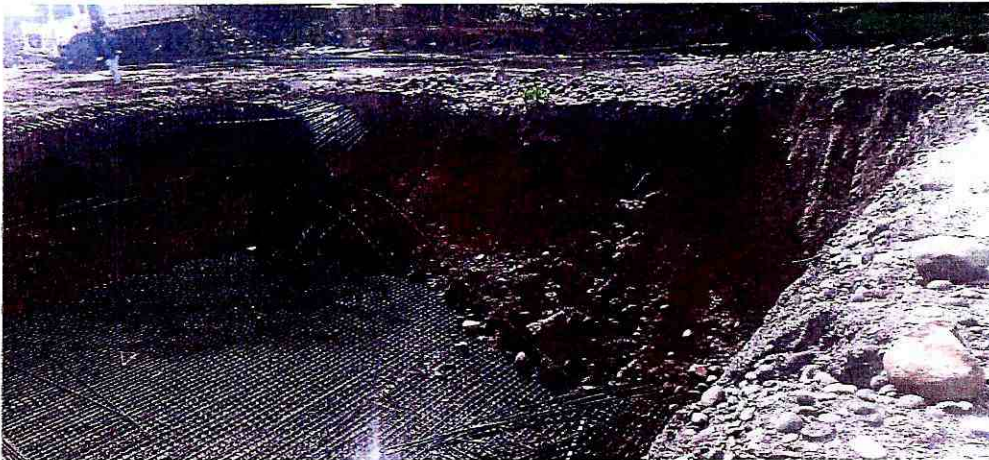
Fotografía 2: Deslizamiento de taludes producto de fuertes lluvias
