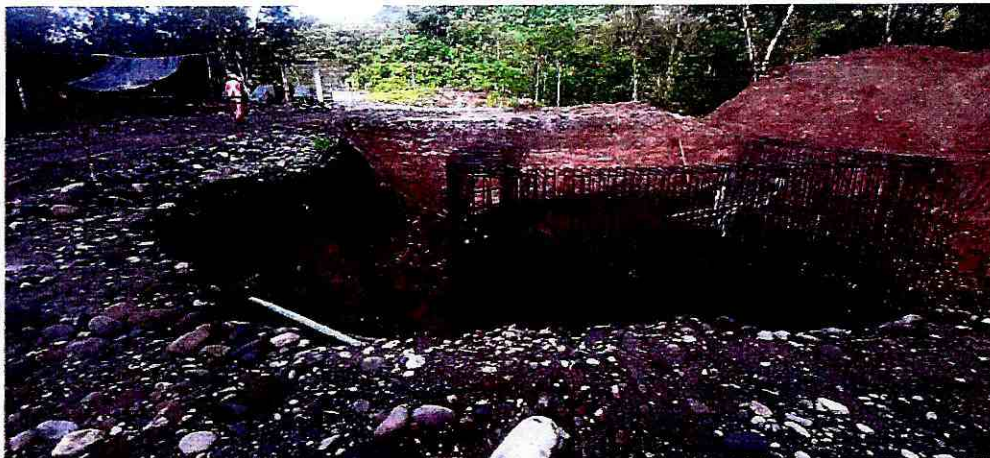
Fotografía 3: Deslizamiento de taludes producto de fuertes lluvias
