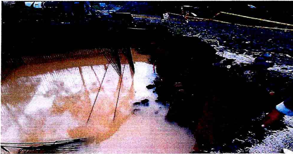
Fotografía 1: Deslizamiento de taludes producto de fuertes lluvias
