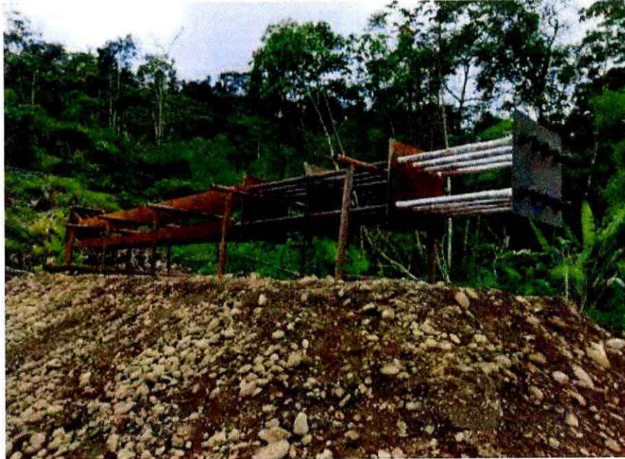
Fotografía 1. Piezas mecánicas de anclaje – margen izquierdo
