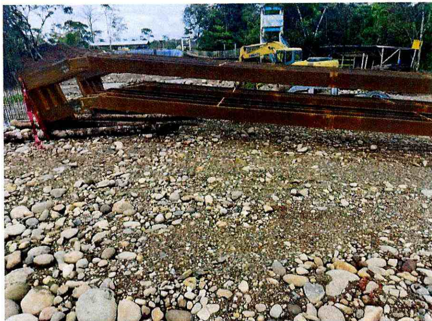
Fotografía 2. Piezas mecánicas de anclaje – margen izquierdo
