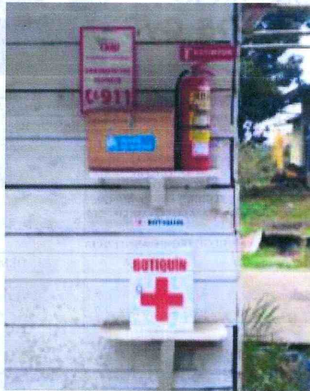
Imagen 8. Botiquín y extintor
